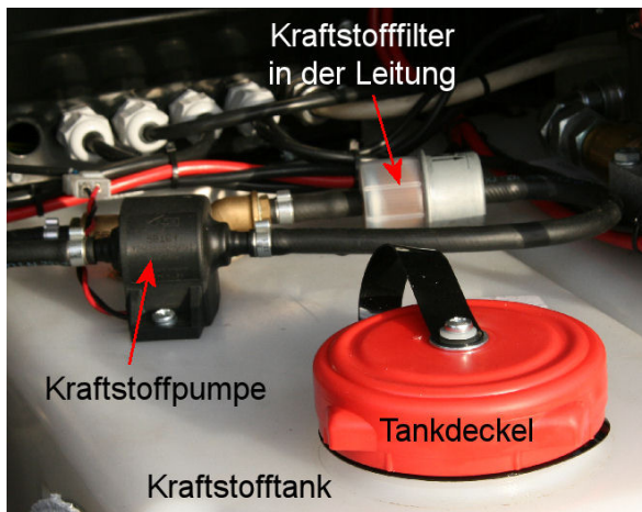
Bild 2-4 Benzinfilter in der Leitung
